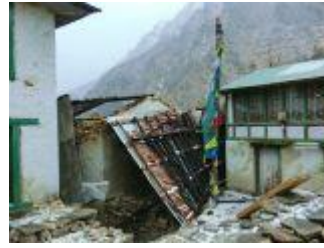
屋根を飛ばされた
